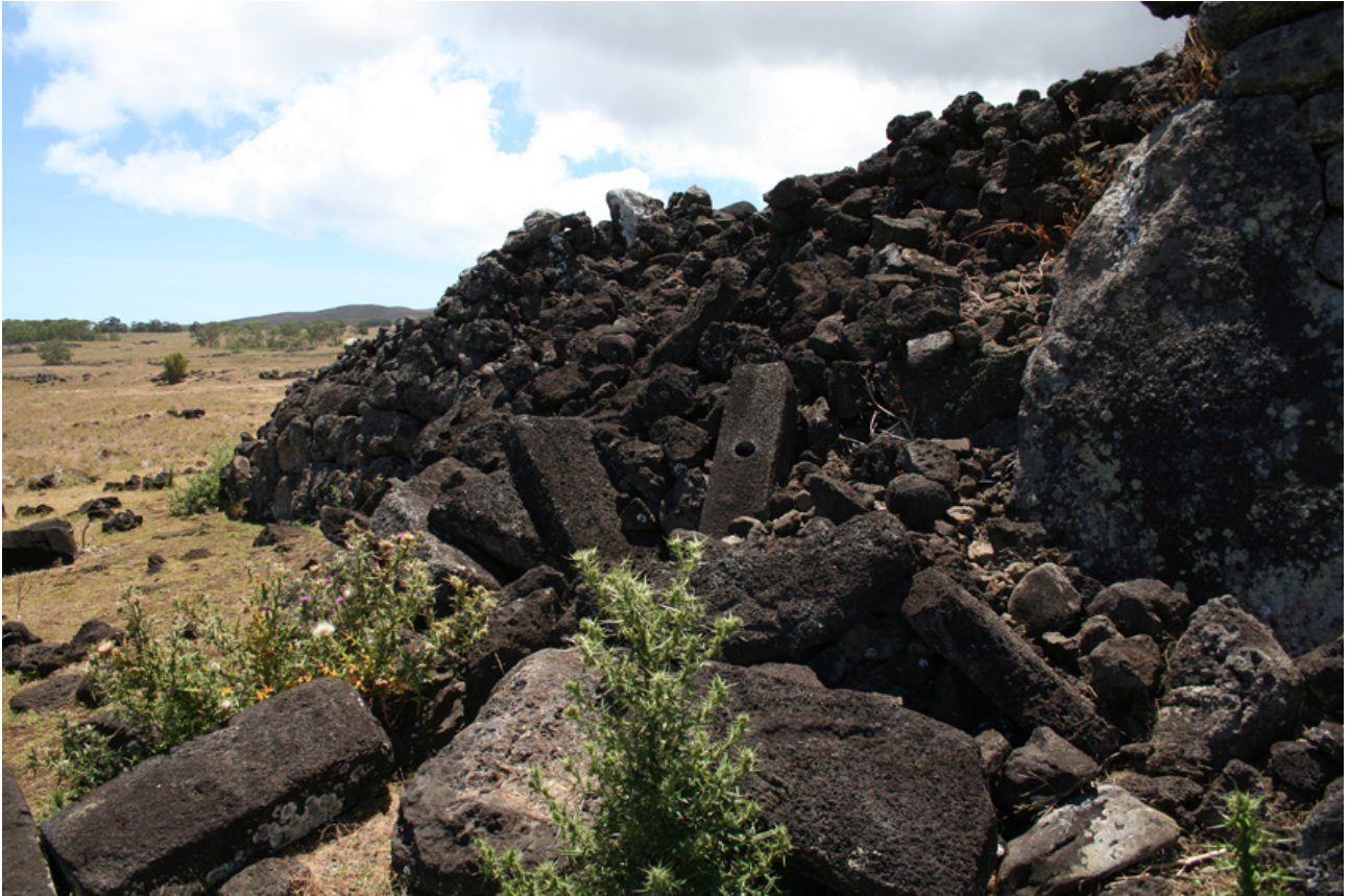
Fig. 4 – Ahu te Peu (côte ouest). À quelque chose, malheur est bon : l’effondrement partiel du mur arrière de l’ ahu a permis de constater la présence de paenga (pierres de fondation de maisons) dans le remplissage de la plate-forme (cliché N. Cauwe).
